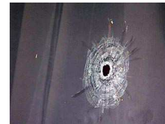
Зображення 1. Вогнепальне пошкодження віконного скла.
