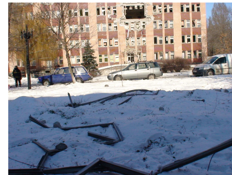
Уламки конструкцій віконних рам
